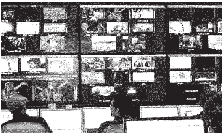
In foto il network operations center Skylogic (Eutelsat) di Torino, il centro di controllo dei segnali televisivi e dati
